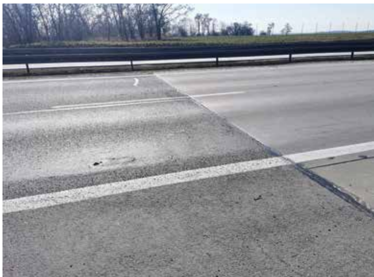
Fot. 6. Widok uszkodzeń na styku nawierzchni betonowej i asfaltowej w km 133+877 Źródło: [9]
