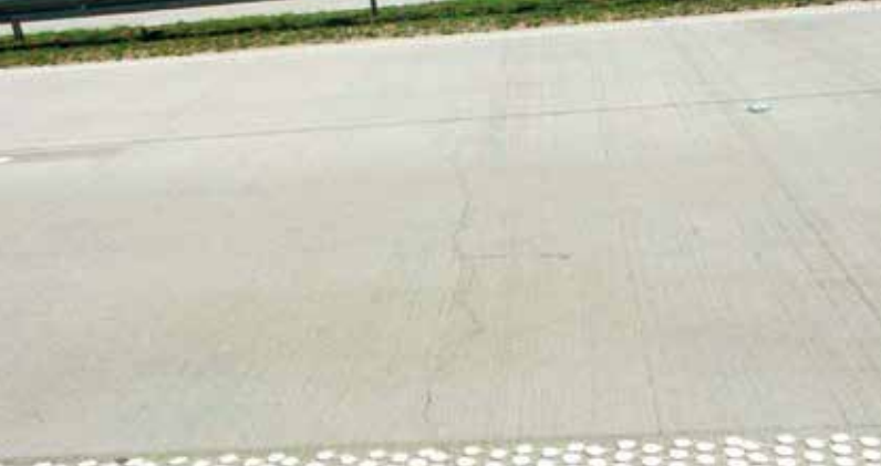
Fot. 1. Widok poprzecznych spękań włosowatych nawierzchni wykonanej ze zbrojonej płyty betonowej o grubości 23 cm, bez szczelin poprzecznych, na podbudowie z chudego betonu. Źródło: [4], [9]
