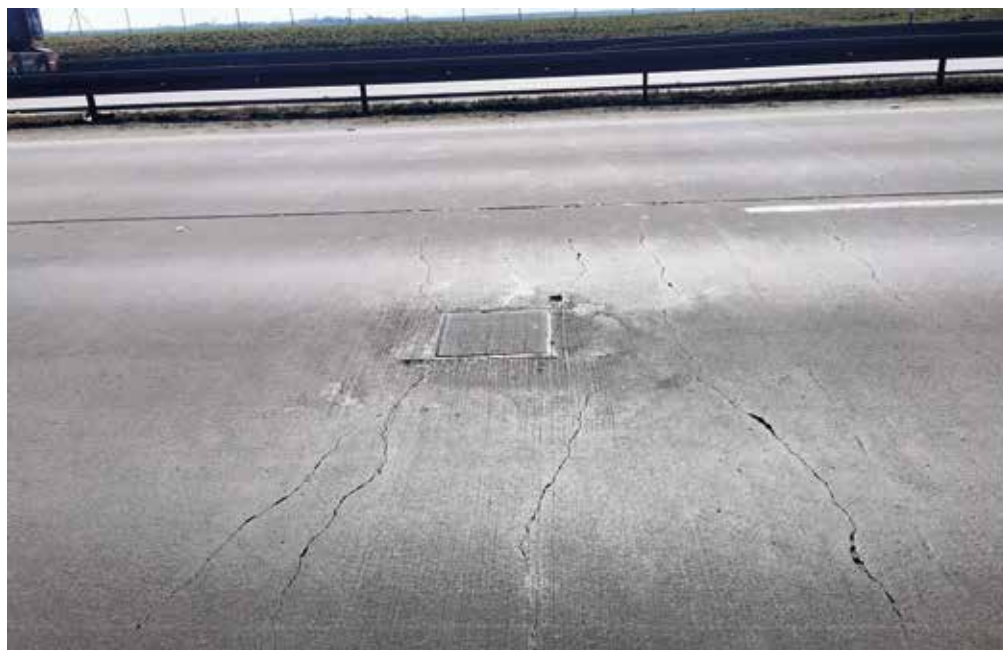
Fot. 4. Widok powiększonych szczelin spękań włosowatych oraz tworzących się niewielkich wybojów i wykruszeń, w okolicach zainstalowanych podczas wykonywania nawierzchni czujników do pomiarów odkształceń i temperatury Źródło: [7], [9]
