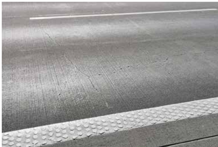
Fot. 8. Widok uszkodzeń powierzchniowych - spękań podłużnych, równoległych do osi jezdni, które łączą się ze spękaniami poprzecznymi i skośnymi Źródło: [9]
