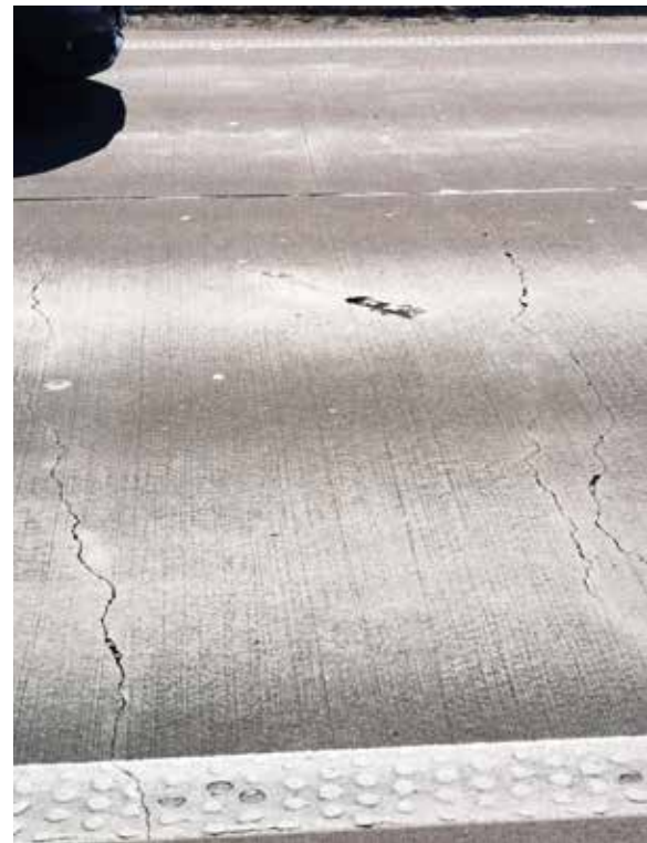
Fot. 10. Wybój na nawierzchni oraz spękania poprzeczne – pas zewnętrzny Źródło: [9]
