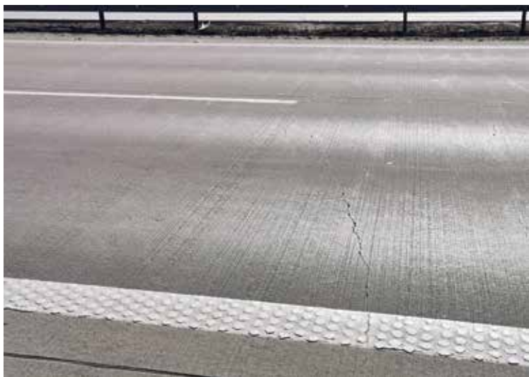
Fot. 7. Widok uszkodzeń powierzchniowych - spękań skośnych do osi jezdni autostrady A4 Źródło: [9]
