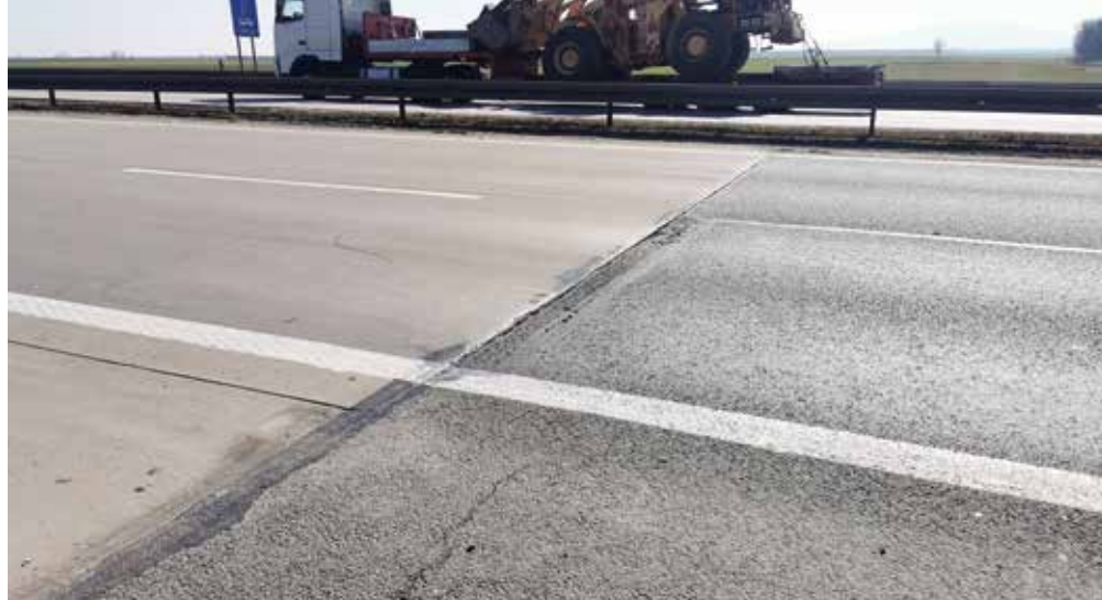
Fot. 5. Widok uszkodzeń na styku nawierzchni betonowej i asfaltowej w km 134+976 Źródło: [9]
