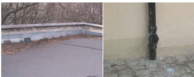
Rys. 5. Przyczyna i skutek zanieczyszczenia rynny i rury spustowej
