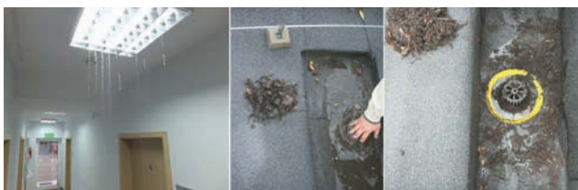
Rys. 3. Efekty niedrożności wpustu dachowego
