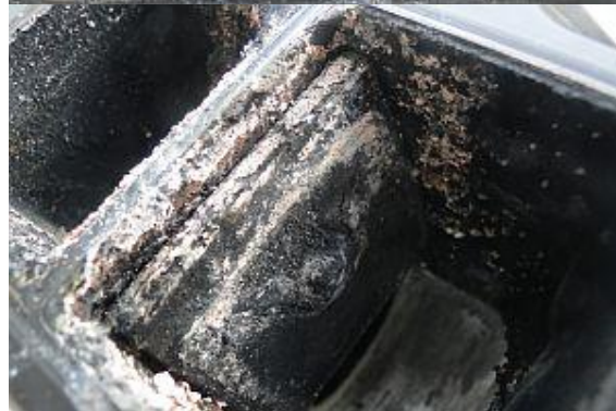
Rys. 6. Osady na wymienniku ciepła EGR – część wlotowa
