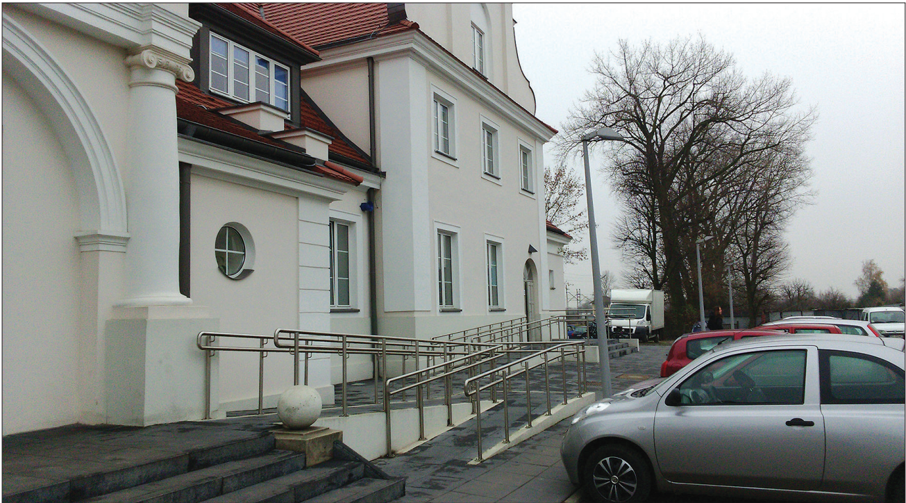
6. Dworzec kolejowy w Kole, rampa dla niepełnosprawnych przed wejściem do budynku. Fot. autor, 2014 6. Koło Railway Station, disabled access ramp at the front entrance to the building. Photo by author, 2014
