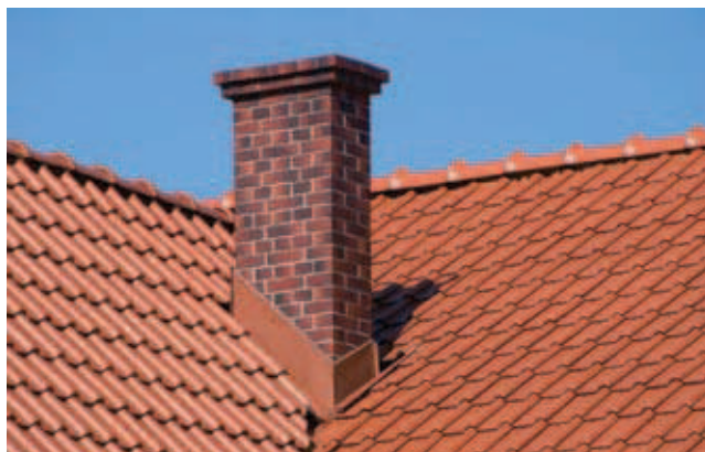
Rys. 11. Skrajnie niekorzystna lokalizacja komina w koszu dachu. Bardzo trudna obróbka blacharska, miejsce stale narażone na przeciekanie [11]
