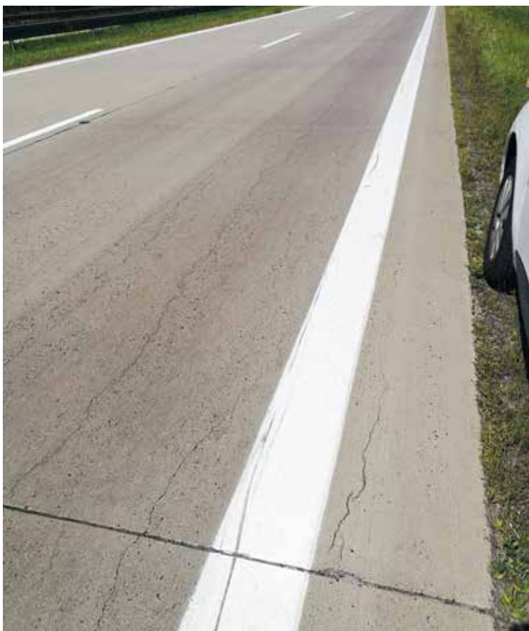
Rys. 12. Spękania podłużne płyty, wykruszenia krawędzi płyt oraz odstąpienie krawędzi płyt od strony pobocza (fotografie autora 2018 r.)
