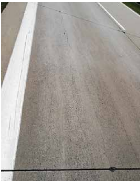
Rys. 10. Wykruszenia podłużnych i poprzecznych krawędzi płyt, spękania przykrawędziowe krótkie oraz spękania podłużne płyty (fotografie autora 2018 r.)
