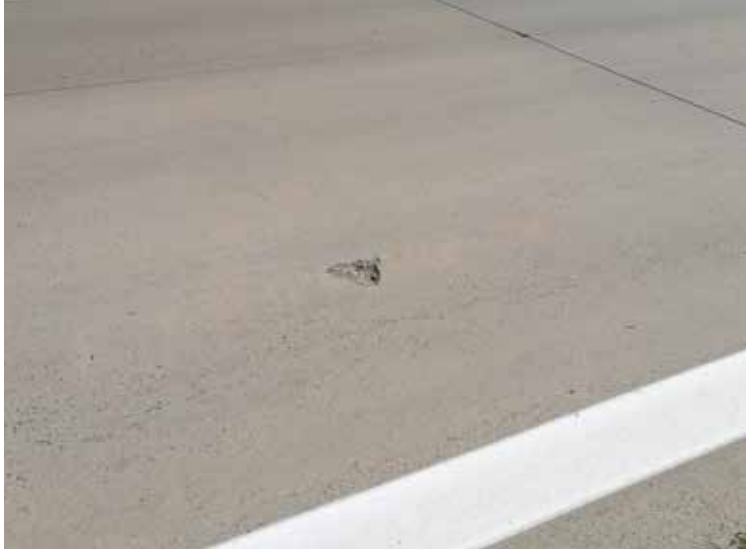
Rys. 11. Wybój w środkowej części płyty oraz uszkodzenia mechaniczne wywołane przez spadający ładunek (fotografie autora 2018 r.)
