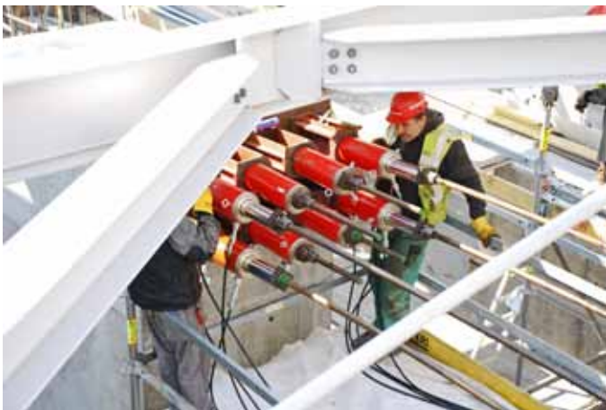
Ryc. 5. Walce do wysuwania rusztu nośnego pomostu
