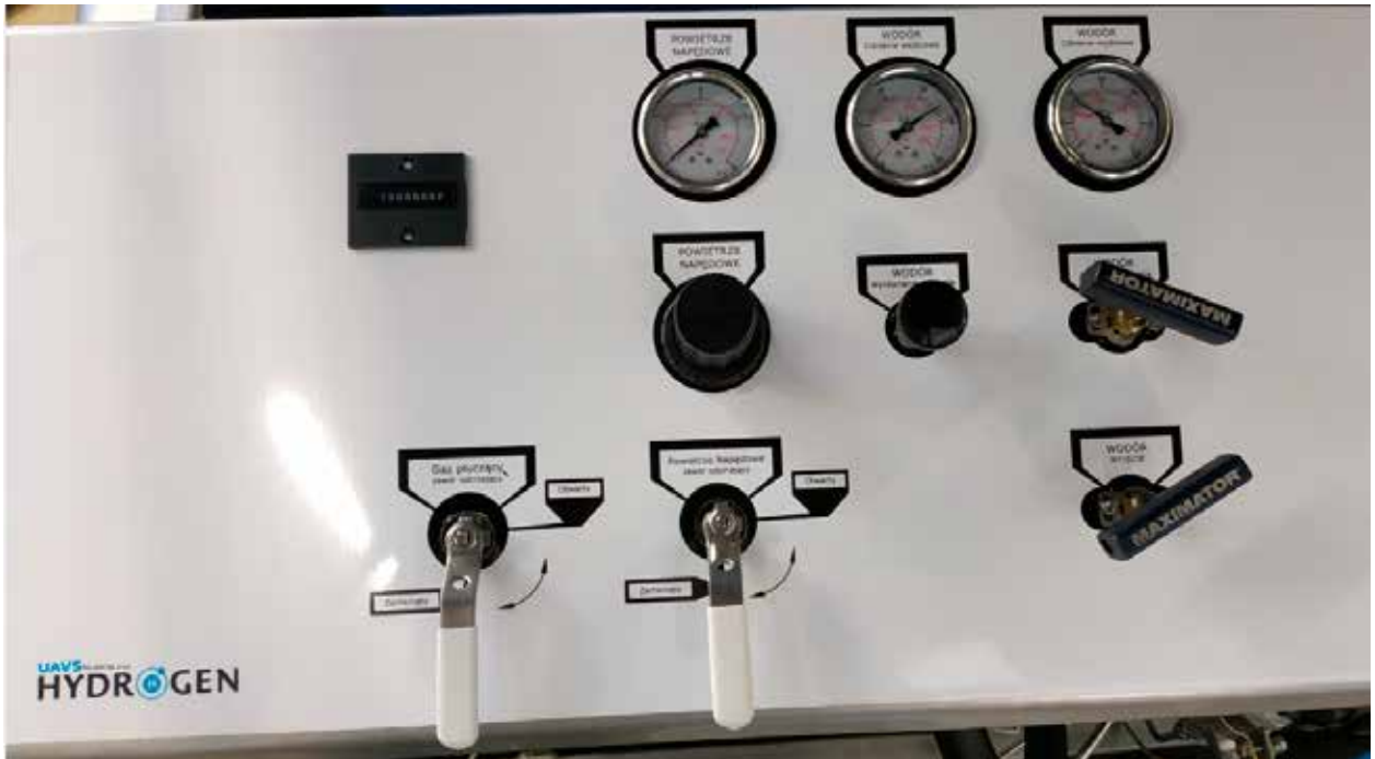
Rys. 7. Panel sterowania pracą stacji tankowania wodoru
