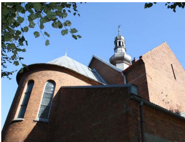
Ryc. 6. Samocice, kościół pw. św. Bartłomieja Apostoła, widok od strony prezbiterium (1937-1953), proj. Włodzimierz Gruszczyński, Mieczysław Gruszczyński, Jan Stobiecki
