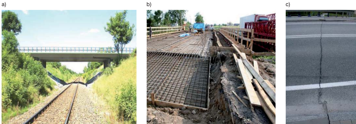
Fot. 3. Wiadukt nad linią kolejową PKP: a) widok po przebudowie, b) widok w trakcie przebudowy, c) pęknięcie nawierzchni jezdni nad krawędzią płyty pomostu
