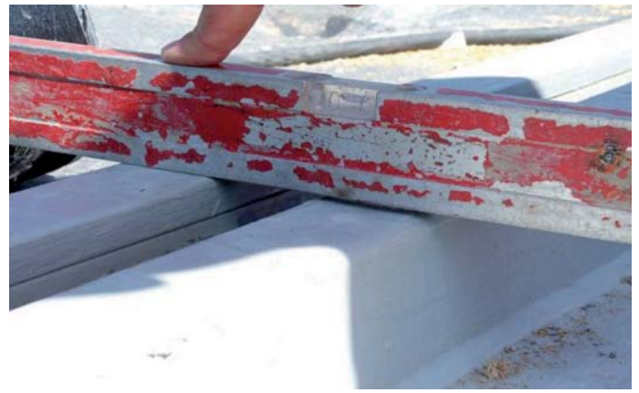
Fot. 10. Wadliwy montaż wysokościowy stalowych profili dylatacyjnych
