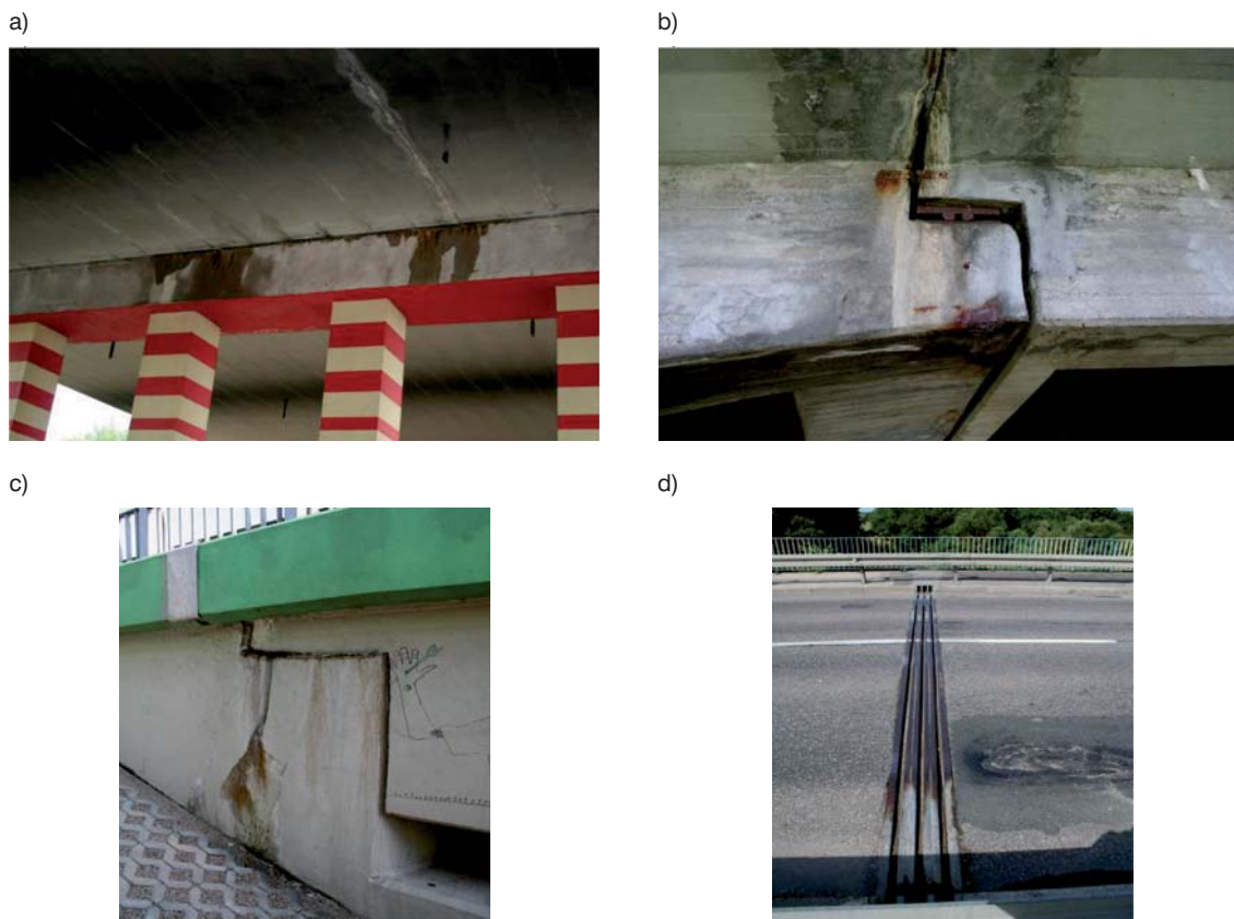
Fot. 1. Uszkodzenia elementów mostu spowodowane wadliwie działającymi urządzeniami dylatacyjnymi: a) uszkodzenia oczepu filara, b) uszkodzenia w strefie przegubu Grebera, c) uszkodzenia przyczółka, d) uszkodzenia nawierzchni jezdni
