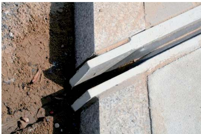
Fot. 13. Blachy urządzenia dylatacyjnego wystają poza obrys krawężników
