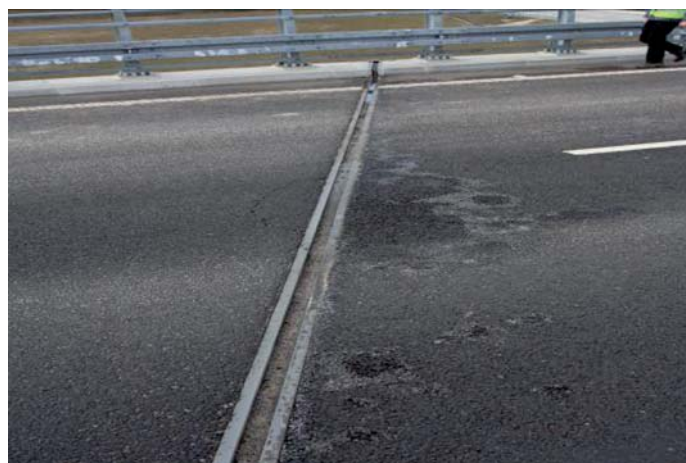
Fot. 8. Ślady na nawierzchni po iniekcji żywicami pustek w strefie zakotwienia urządzenia dylatacyjnego
