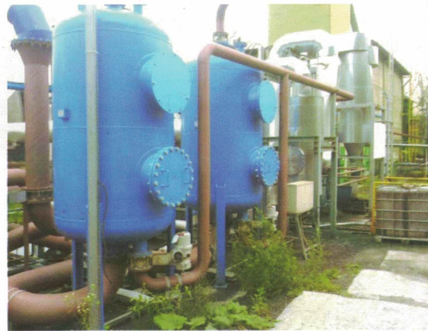
Rys. 1. Fragment instalacji PZW KWK „Wieczorek” wg technologii GIG w części naziemnej (fot. autora)
