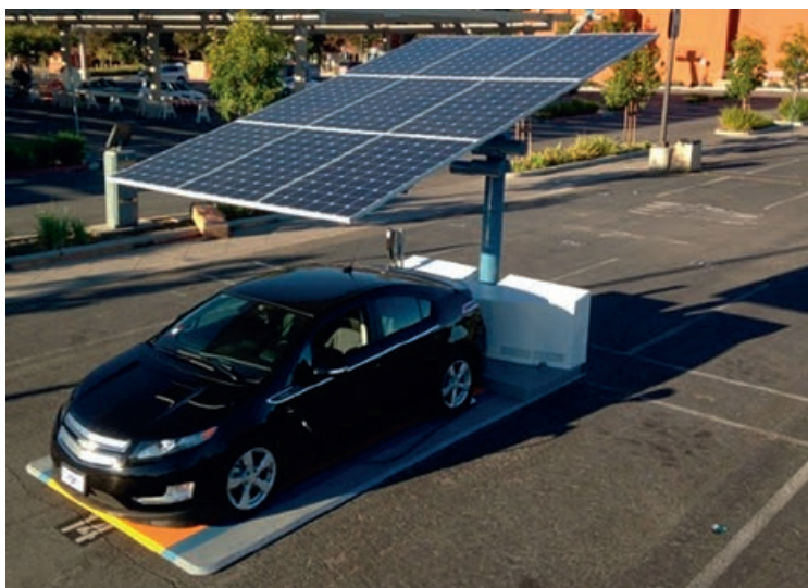
Fot. 1. Autonomiczna stacja ładowania pojazdów zasilana z ogniw fotowoltaicznych
