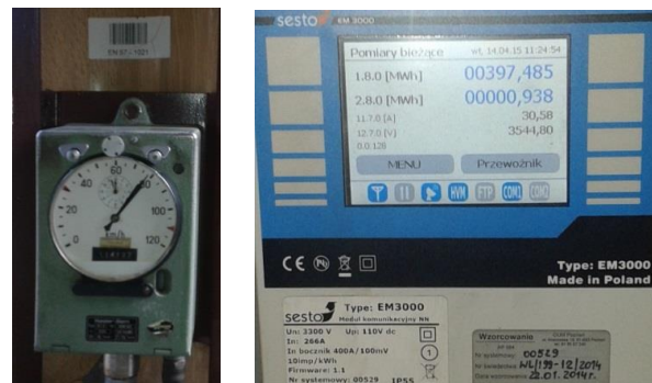
Rys. 3. Rejestrator prędkości oraz początkowe wskazania licznika zużycia energii elektrycznej EM 3000
