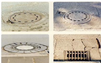
Rys. 1. Zdjęcia różnego typu uszkodzonych studzienek
