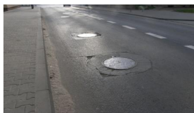
Rys. 2. Zdjęcie szeregu uszkodzonych studzienek
