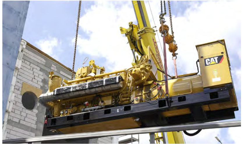
Układ kogeneracyjny o mocy 3 x 2MWe. Model agregatu: CAT G3516H. Typ gazu zasilającego: gaz ziemny, wysokometanowy typu E
