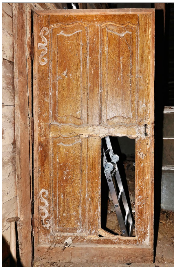
Ryc. 10. Pozostałości pierwotnej, rokokowej stolarki drzwiowej; fot. M. Warchoł 2020.
