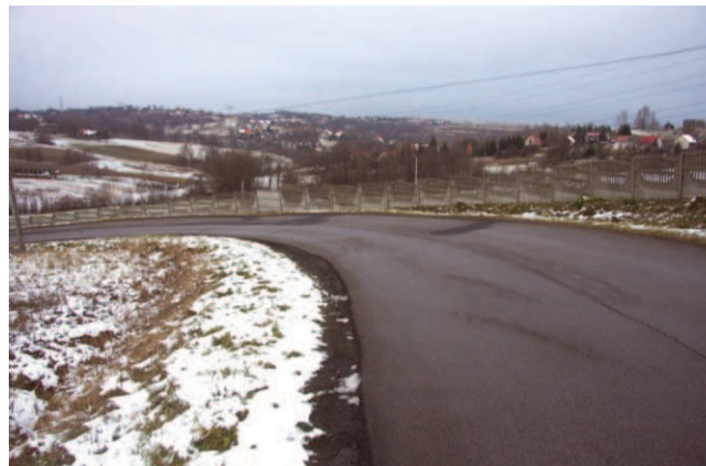
Rys. 4b. Widok aktywnego koluwium (odkształcenia i uszkodzenia nawierzchni drogowej)
