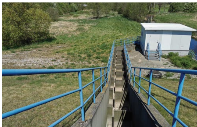
Rys. 4. Przeplawka dla ryb przy małej elektrowni wodnej (archiwum własne)
