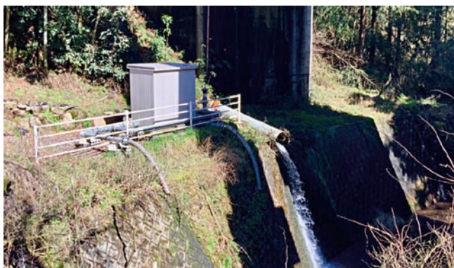
Rys. 11. Turbina energetyczna zainstalowana w sieci kanalizacji sanitarnej (źródło zdjęć: © Ricoh)
