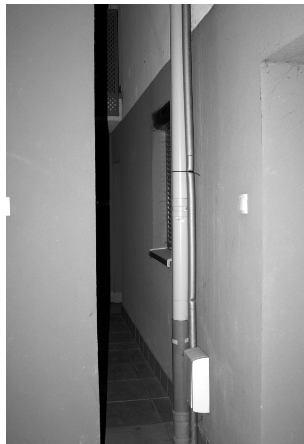
il. 3. Odległość okna od ściany windy wynosi 64 cm. (autor: Karolina Warzocha) / A distance between the window and the elevator's wall is 64 cm. (author: Karolina Warzocha)
