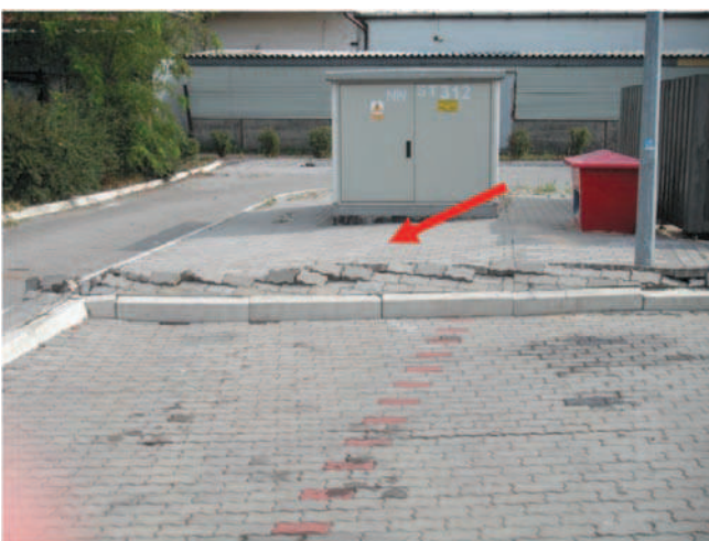
Rys. 2. Wypiętrzenie kostki brukowej w chodniku Fig. 2. Concrete cubes elevation in pavement
