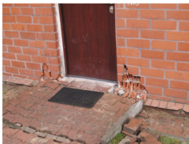
Rys. 11. Uszkodzenie cokołu w okolicy północnego wejścia do budynku D Fig. 11. Pedestal damage near the northern entrance to building D
