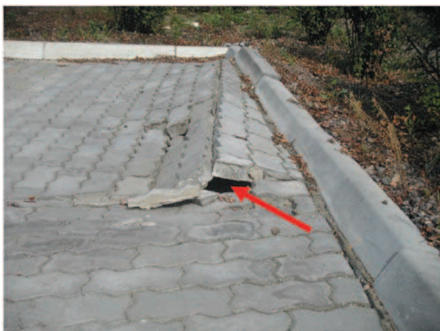
Rys. 1. Wypiętrzenie kostki brukowej i obrót krawężnika Fig. 1. Concrete cubes elevation and turn of kerb
