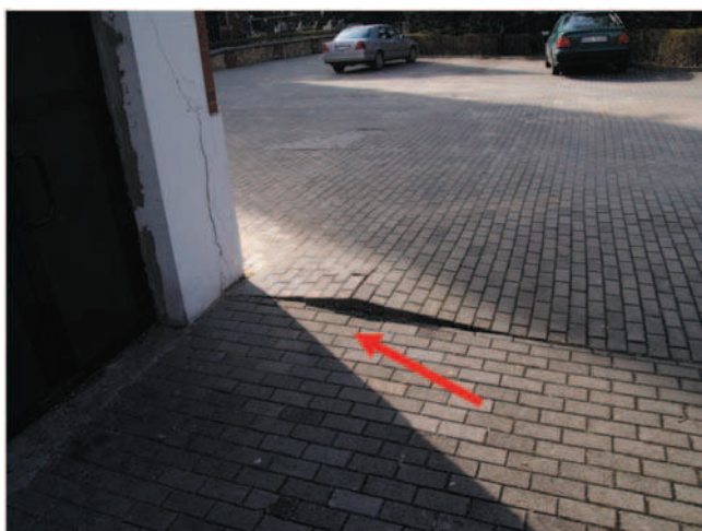
Rys. 3. Wypiętrzenie kostki brukowej na placu Fig. 3. Concrete cubes elevation on the site
