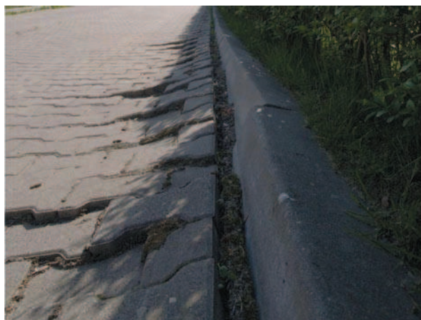
Rys. 10. Poprzeczna deformacja krawężnika Fig. 10. Crosswise deformation of the kerb
