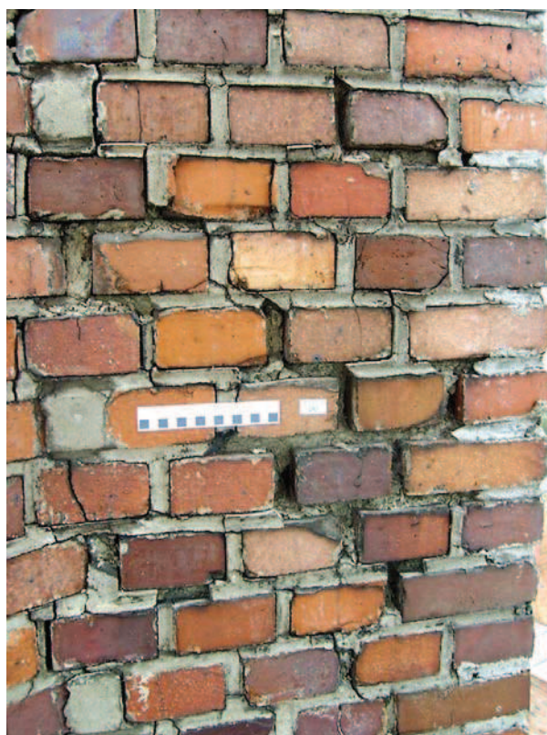
Ryc. 6. Segment E. Bok prawy. Degradacja lica muru. Siatka spękań fug i pojedynczych cegieł, liczne ubytki fug, korozja odsłoniętej zaprawy w spoinach (autor: M. Łaba), 2012
