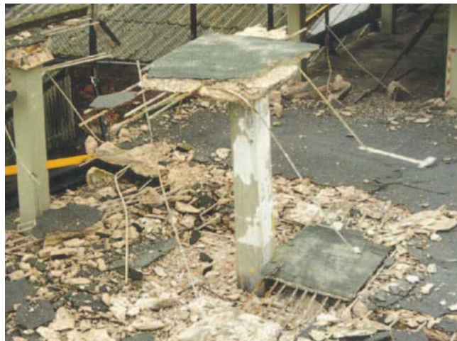
Rys. 1. Częściowe zawalenie się Pipers Row Car Park (parkingu) w Wolverhampton, 1997 r. [1]
