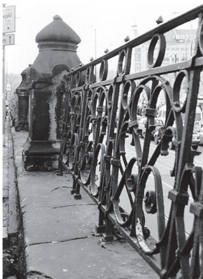
Zniszczone dekoracyjne barierki metalowe (Fot. M. Majewski)
