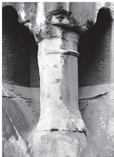
Fragment narożnej niszy z kolumnką. Poważne zniszczenia struktury kamienia (Fot. M. Majewski)
