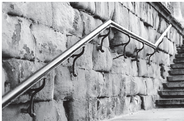
Zniszczony kamienny mur oporowy schodów od strony pñ.-wsch. (Fot. M. Majewski)
