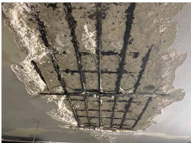
Rys. 2. Widok na skorodowany spód stropu
