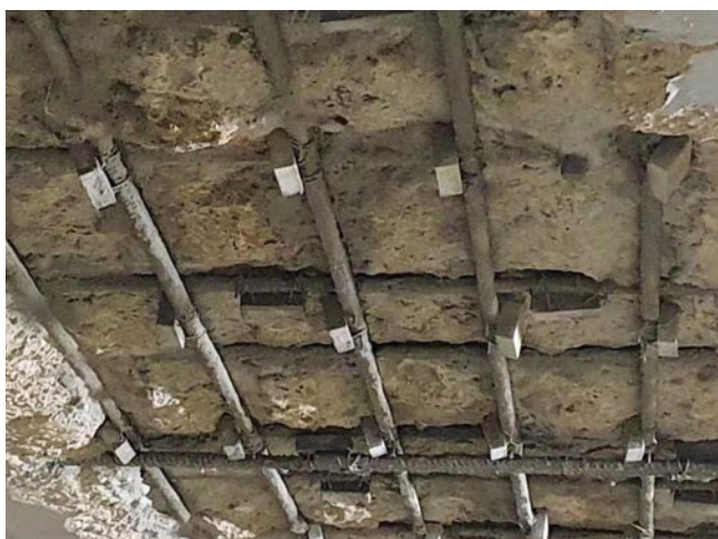
Rys. 3. Widok na spód stropu z zamontowanymi protektorami cynkowymi
