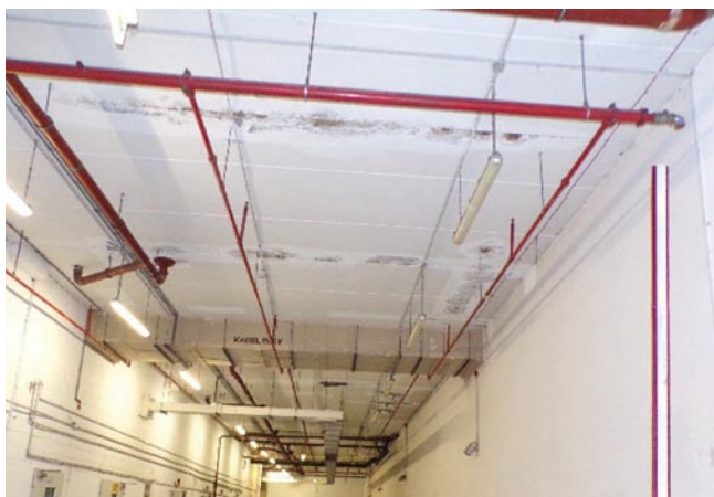
Rys. 1. Ślady przecieków widoczne na stropie z płyt strunobetonowych
