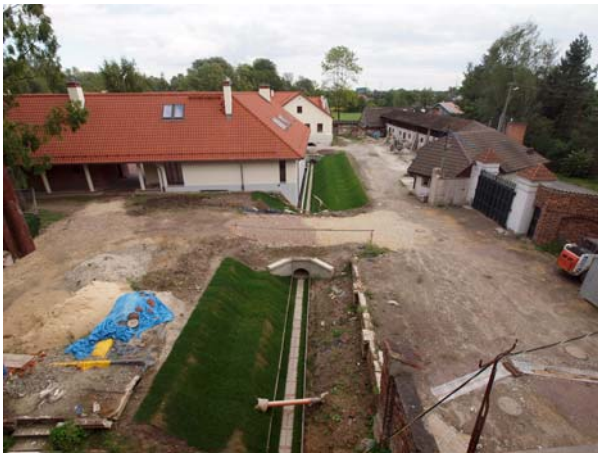
Ryc. 15. Trasa restytuowanego fragmentu młynówki z dwoma mostkami, na odcinku pomiędzy przeoratem i budynkiem barokowym; widok z przeoratu Fig. 15. Course of the restored fragment of the mill-leaf with two bridges, in the section between the Priory and the Baroque building; view from the Priory
