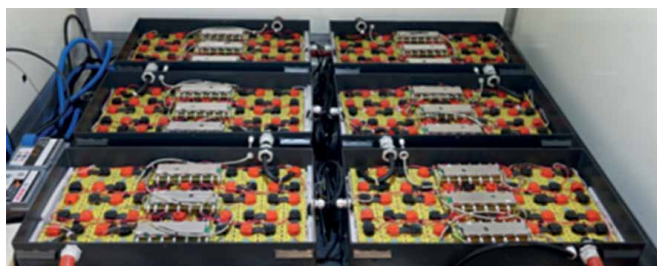
Rys. 5. Magazyn energii BAT-201
