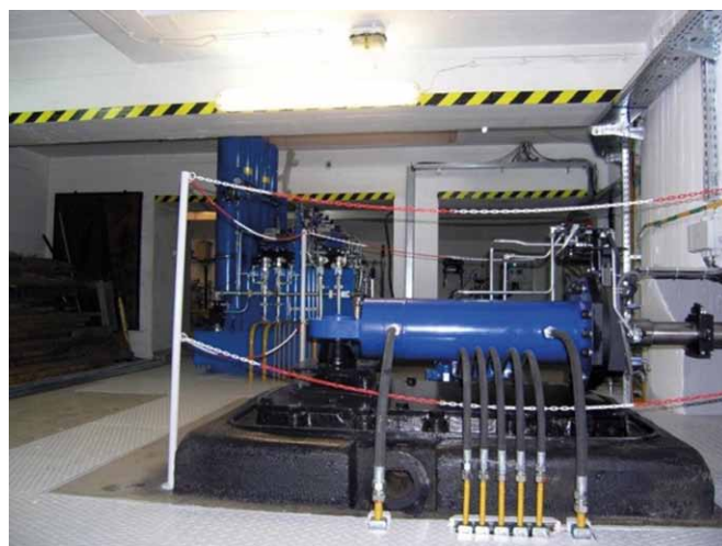
Rys. 10. Elektrohydrauliczny układ sterowania turbiną Kaplana w EW Dąbie wykonany przez Instytut Energetyki Oddział Gdańsk
