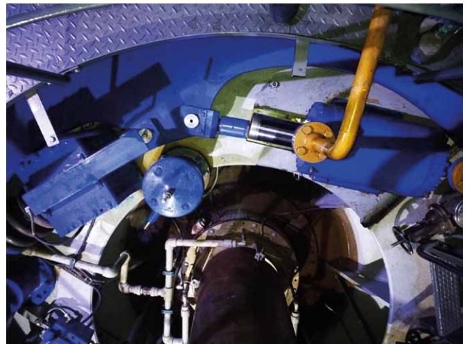
Rys. 5. Pierścień regulacyjny turbiny Kaplana z siłownikiem hydraulicznym i zespołem sprężyn domykających aparat kierowniczy
