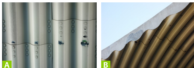
Ryc. 7. Przykłady uszkodzeń mechanicznych powłok ze stalowych blach falistych: a) uszkodzenie powłoki w wyniku uderzenia pojazdu, b) uszkodzenie mechaniczne gzymsu żelbetowego (wieńca) oraz konstrukcyjnej stalowej blachy falistej, fot. A. Wysokowski
