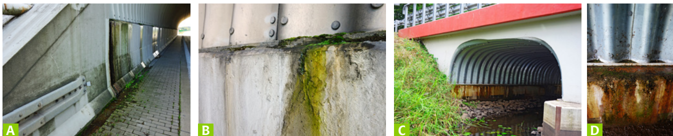
Ryc. 3. Przykłady fotograficzne ilustrujące typowy problem przecieków przez konstrukcję w obrębie podpór w obiektach gruntowo-powłokowych – obiekt typu ekomost (A, B), przepust drogowy (C, D), fot. A. Wysokowski
