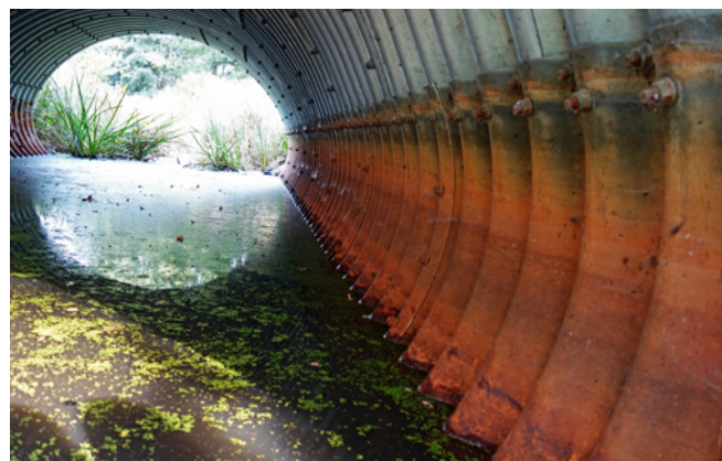
Ryc. 6. Przykład korozji powierzchniowej powstałej ze względu na długotrwałe narażenie powłoki na czynniki korozyjne na poziomie wahań zwierciadła wody, fot. A. Wysokowski
