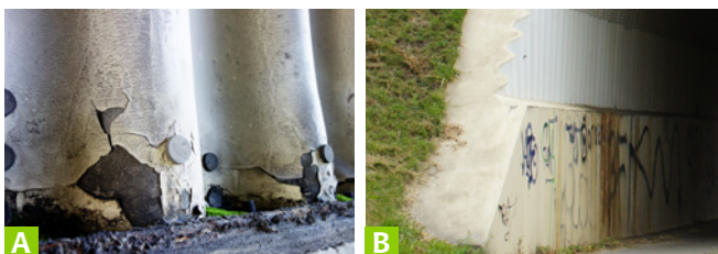
Ryc. 4. Początkowe stadium korozji konstrukcji z blach falistych: a) ogólna korozja na skutek zniszczenia powłok antykorozyjnych, b) korozja w strefie oparcia powłoki stalowej na fundamencie żelbetonowym – widoczne rdzawe zacieki na powierzchni fundamentu, świadczące o korozji konstrukcji stalowej, fot. A. Wysokowski
