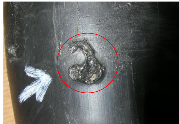
Rys.3. Uszkodzenia kablowych linii elektroenergetycznych spowodowane innymi pracami montażowymi [1]
