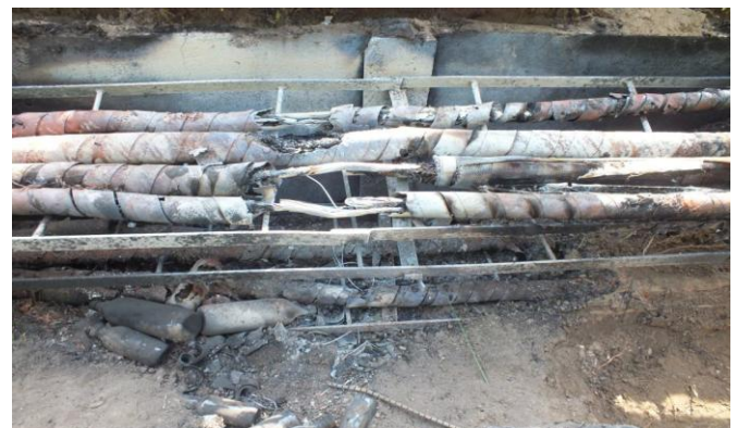
Rys.4. Uszkodzenie kilku linii kablowych 15 kV spowodowane zwarciem [4]
