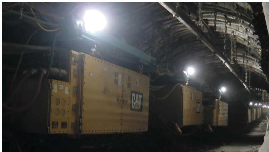
Rys. 18. Przełączniki częstotliwości kompleksu Bogdanka II zlokalizowane w pociągu aparaturowym
