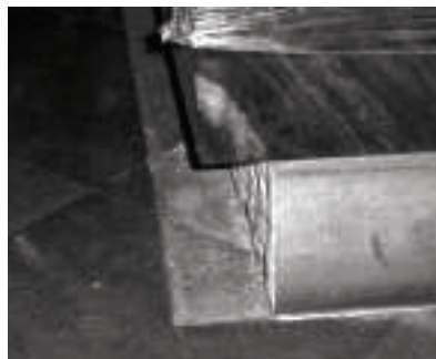
Ryc. 7. Podcięta część cokołowa Fig. 7. Undercut pedestal section
