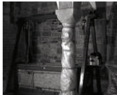
Ryc. 8. Zabezpieczony sarkofag i zmontowana konstrukcja nośna Fig. 8. Secured sarcophagus and assembled lifting construction
