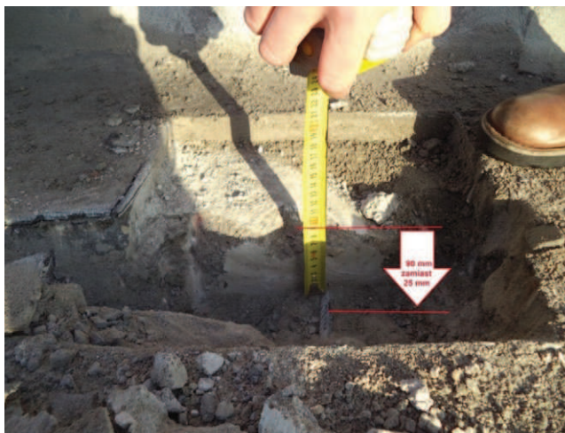
Fot. 5. Przykład niewłaściwej lokalizacji i ilości prętów zbrojenia stropu monolitycznego ujawnionej podczas ekspertyzy
