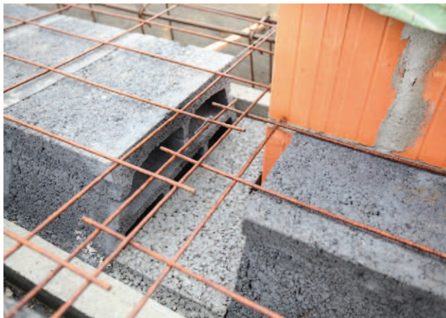
Fot. 4. Przykład za małego zakładu prętów na połączeniu siatek zgrzewanych w nadbetonie stropu gęstożebrowego
