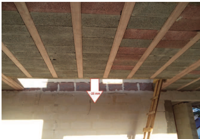
Fot. 3. Przykład niewłaściwego wykonania wymianu i żeber rozdzielczych powodujące nienormowe ugięcie stropu
