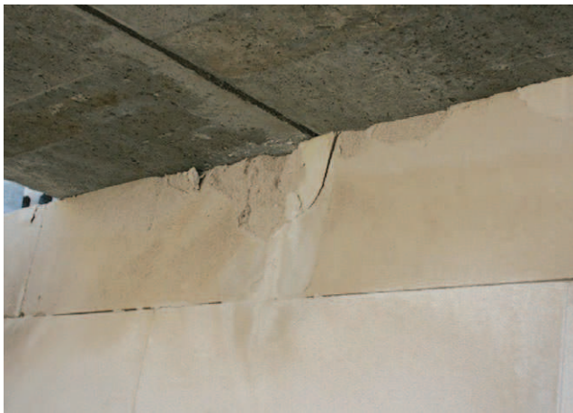
Fot. 6. Przykład uszkodzeń ściany z bloczków betonu komórkowego pod wpływem bezpośredniego oparcia stropu
