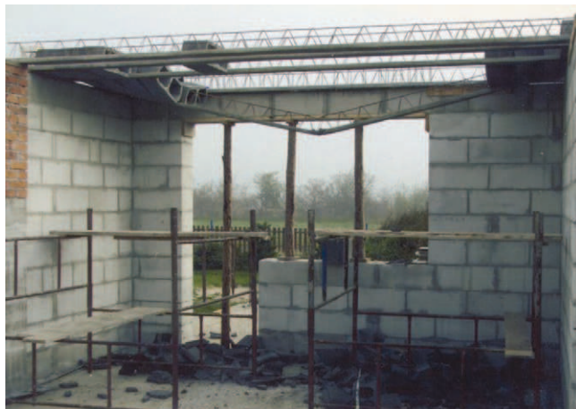
Fot. 1. Przykład awarii budowlanej spowodowanej brakiem podparcia
