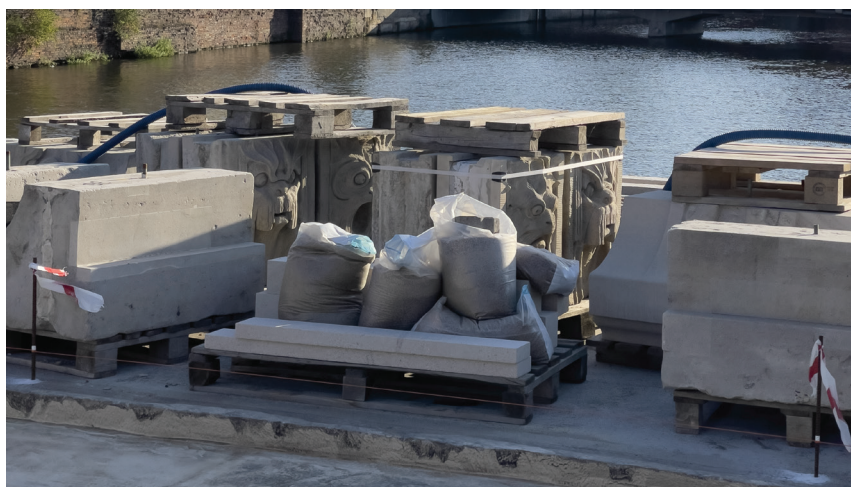
Fot. 15. Maszkarony przygotowane do montażu na moście Pomorskim, stan na 12.08.2022; źródło: fot. autora
