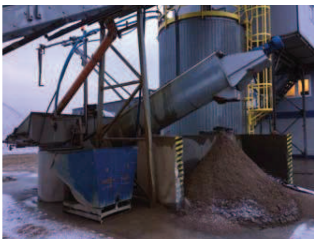
Rys. 1. Typowa instalacja do recyklingu poprodukcyjnych pozostałości mieszanki betonowej
