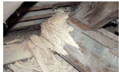
Rys. 26. Destrukcja podwaliny i belki stropowej nad prezbiterium Fig. 26. Destruction of sleeper and ceiling beams over the chancel
