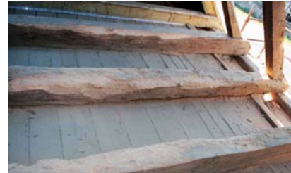
Rys. 35. Destrukcja belek stropowych nad prezbiterium
