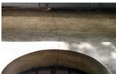
Rys. 20. Zarysowanie łuku nadokiennego w ścianie ośmiobocznej nawy Fig. 20. Cracking of window arch in the octagonal nave wall
