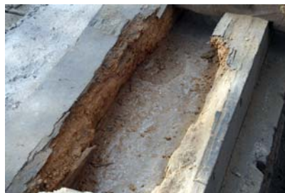
Rys. 23. Głęboka destrukcja belek podwalinowych nad zakrystią Fig. 23. Deep destruction of sleeper beams over the sacristy
