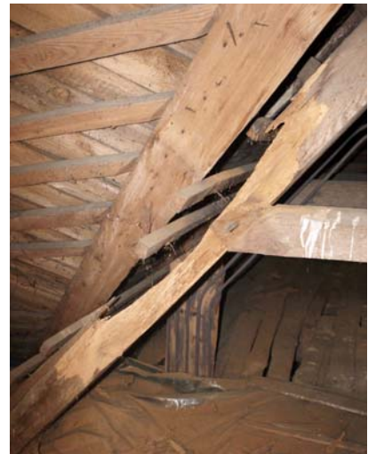
Rys. 25. Destrukcja zastrzału w więźbie nad prezbiterium Fig. 25. Destruction of strut in the roof structure over the chancel
