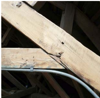
Rys. 31. Wysunięcie czopa jętki z zastrzału i uszkodzenie zastrzału na skutek deformacji poziomych spowodowanych brakiem połączenia zastrzałów i krążyn z belkami stropowymi
