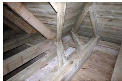
Rys. 34. Odtworzenie krokwi koszowej i narożnej oraz belek stropowych na styku zakrystii i prezbiterium
