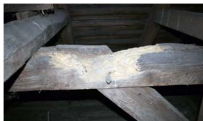
Rys. 24. Głęboka destrukcja ryglu w więźbie nad zakrystią Fig. 24. Deep destruction of beam in the roof structure over the sacristy
