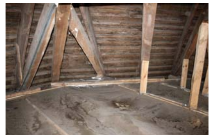
Rys. 27. Folia pokrywająca belki stropowe nad ośmioboczną nawą. Widoczne ślady przecieków przez nieszczelne pokrycie pseudokopuły Fig. 27. Membrane covering the ceiling beams over the octagonal nave. Traces of leakage through untight covering of pseudo-dome
