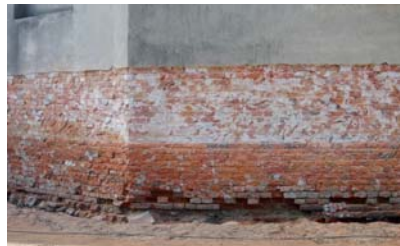
Rys. 21. Destrukcja cegły w ścianie ośmiobocznej nawy Fig. 21. Masonry destruction in the octagonal nave wall
