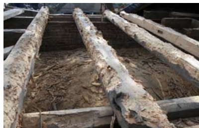
Rys. 22. Belki stropowe nad zakrystią zniszczone powierzchniowo przez owady Fig. 22. Ceiling beams over the sacristy with surface damaged by insects
