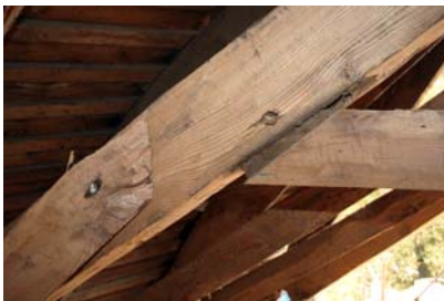
Rys. 30. Wysunięcie czopa jętki z zastrzału na skutek deformacji poziomych spowodowanych brakiem połączenia zastrzałów i krążyn z belkami stropowymi
