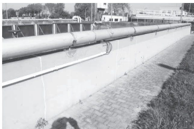
Rys. 6. Odpryski powłoki elastycznej
