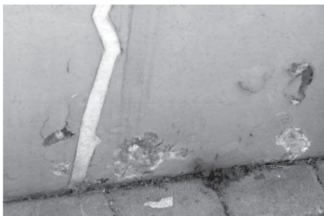
Rys. 5. Rysy w ścianie (wypełnione i niewypełnione)
