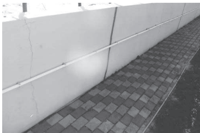
Rys. 4. Rysy w ścianie (wypełnione i niewypełnione)
