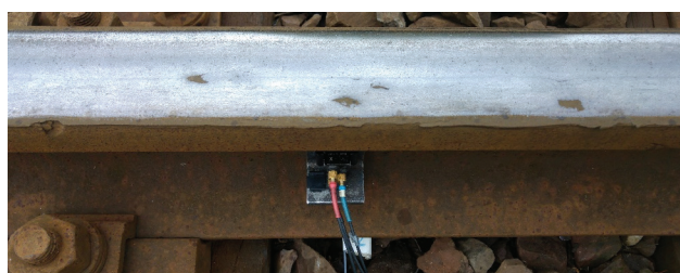
Rys. 2. Wada 221 – uszkodzenie powierzchni tocznej [fot. autorów]
