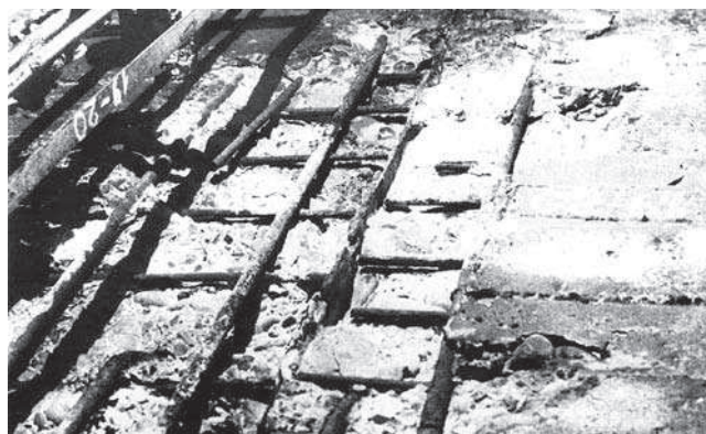
Rys. 10. Korozja zbrojenia płyty żelbetowej w zakładach chemicznych
