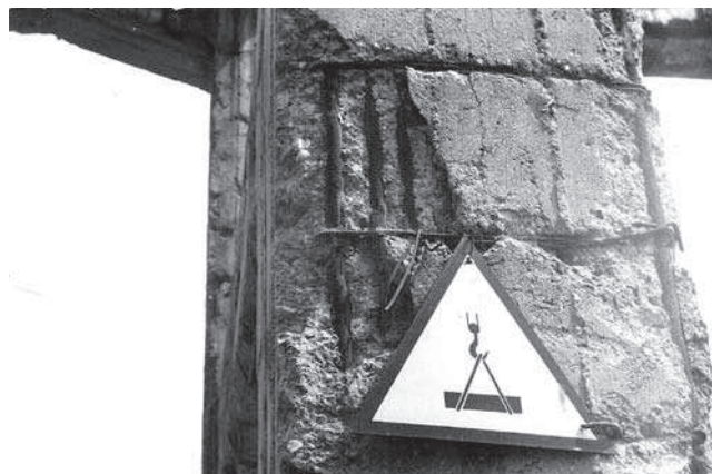
Rys. 8. Korozja zbrojenia słupa żelbetowej estakady
