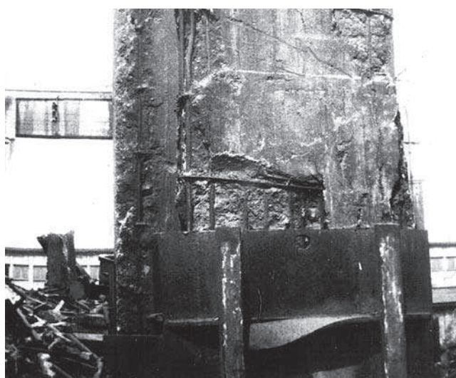
Rys. 9. Korozja zbrojenia słupa żelbetowego
