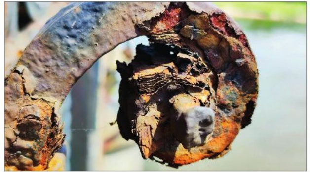
Fot. 4. Zardzewiały fragment zabytkowej balustrady
