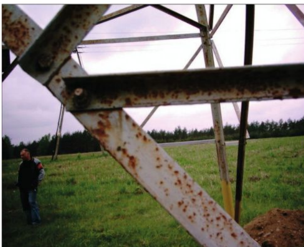
Fot. 3. Postępująca korozja wieży przesyłowej
