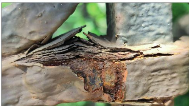
Fot. 1. Korozja na moście
