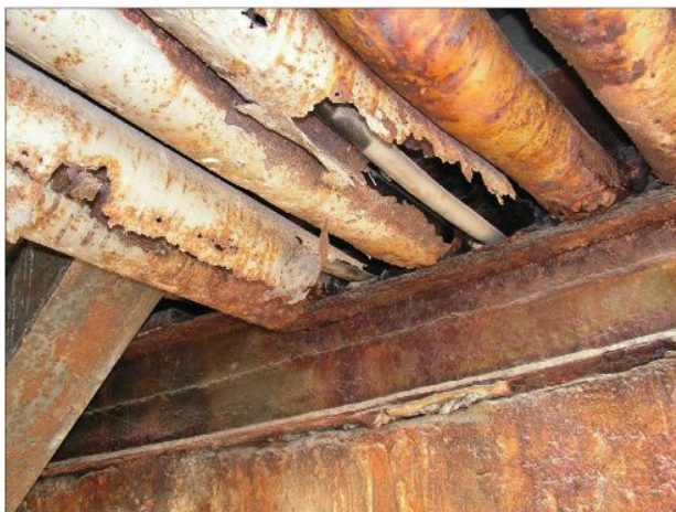
Fot. 2. Korozja na moście
