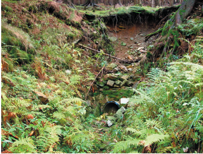
Ryc. 4. Nowe okno sztolni „Marianna” na stokach Rudki (fot. A. Marek); stan z dnia 2.10.2016 r.
