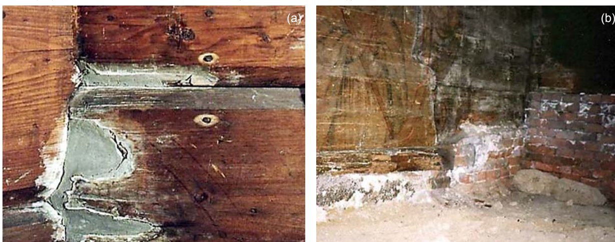
Ryc. 6. Niefachowe naprawy podwalin przez wypełnienie ubytków: a) naprawy ubytków zaprawą cementową – kaplica pw. św. Jadwigi Śląskiej w Wiśle Czarnem (XX w.), b) kościół pw. św. Michała Archanioła w Żernicy (XVII w.) – murowana ściana w miejscu uszkodzonej podwaliny i bali ścian wieńcowych
