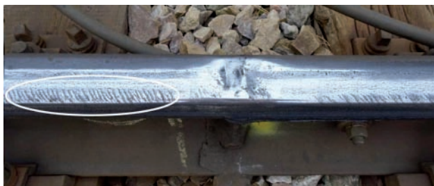
Rys. 2. Pęknięcia krawędziowe o różnym nasileniu w bezpośrednim sąsiedztwie złącza spawanego [fot. I. Mikłaszewicz]
