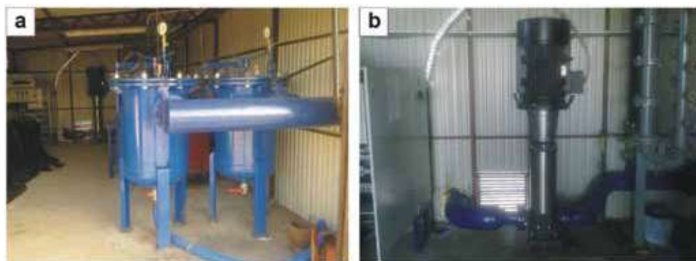
Rys. 3. Instalacja systemu geotermalnego Skierniewice GT-1 – Skierniewice GT-2; filtr workowo-magnetyczny (a) i pompa obiegowa (b) (fot. B. Bielec, na podstawie Kępińska i in., 2011)
