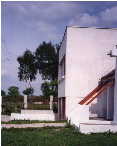
Rys. 5. Dom PD2 po tynkowaniu uszkodzonych ścian zewnętrznych – zdjęcie 1990 r. (źródło: archiwum autora)
