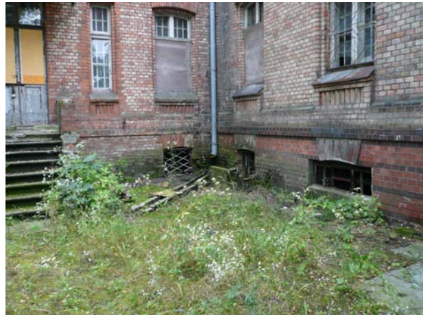
Ryc. 3. Budynek główny, widok elewacji północno-zachodniej, zacieki, algi w strefie przyziemia Fig. 3. Main building: view of the north-west façade. Damp patches and algae on basement walls
