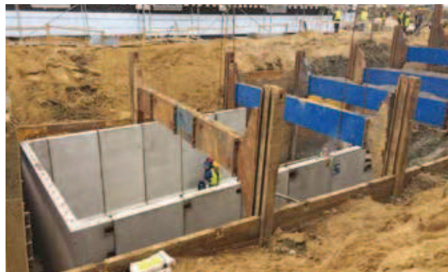
Rys. 10 i 11. Ogólny widok przedstawiający budowę zbiornika retencyjnego z wykorzystaniem elementów prefabrykowanych przy zabezpieczeniu wykopu obudową firmy Koprzas
