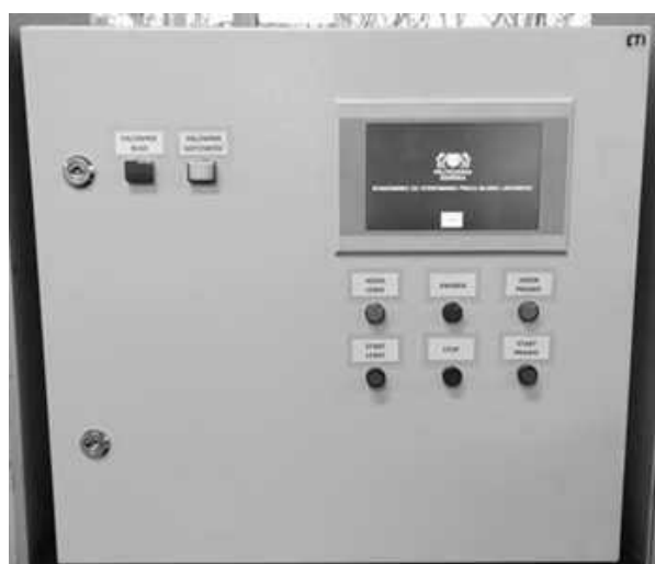
Rys. 5. Widok elewacji szafy sterowniczej
