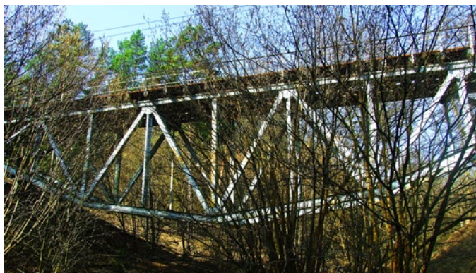
Obiekt przed przebudową – widok ogólny mostu. Widoczne nacieki korozyjne
