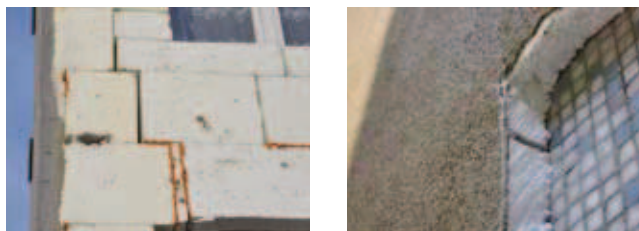
Rys. 1, 2. Wadliwe łączenie poszczególnych płyt izolacji termicznej w systemie ETICS
