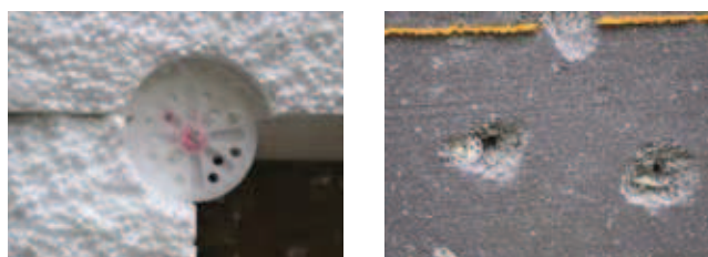
Rys. 3, 4. Nieprawidłowy sposób mocowania łączników mechanicznych do ścian
