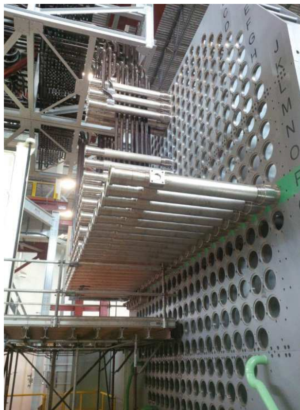
Fot. 5. Końcówki rur ciśnieniowych i rury odpływowe i dopływowe Photo 5. End fittings and feeders
